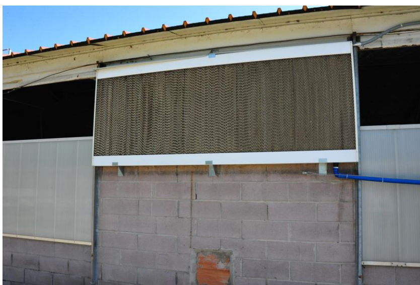
Figura 5 Impianto di raffrescamento (cooling)
